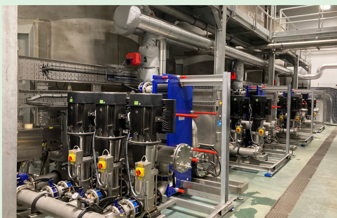
配备格兰富CR泵的四台Hydro MPC-E增压机组装置。
