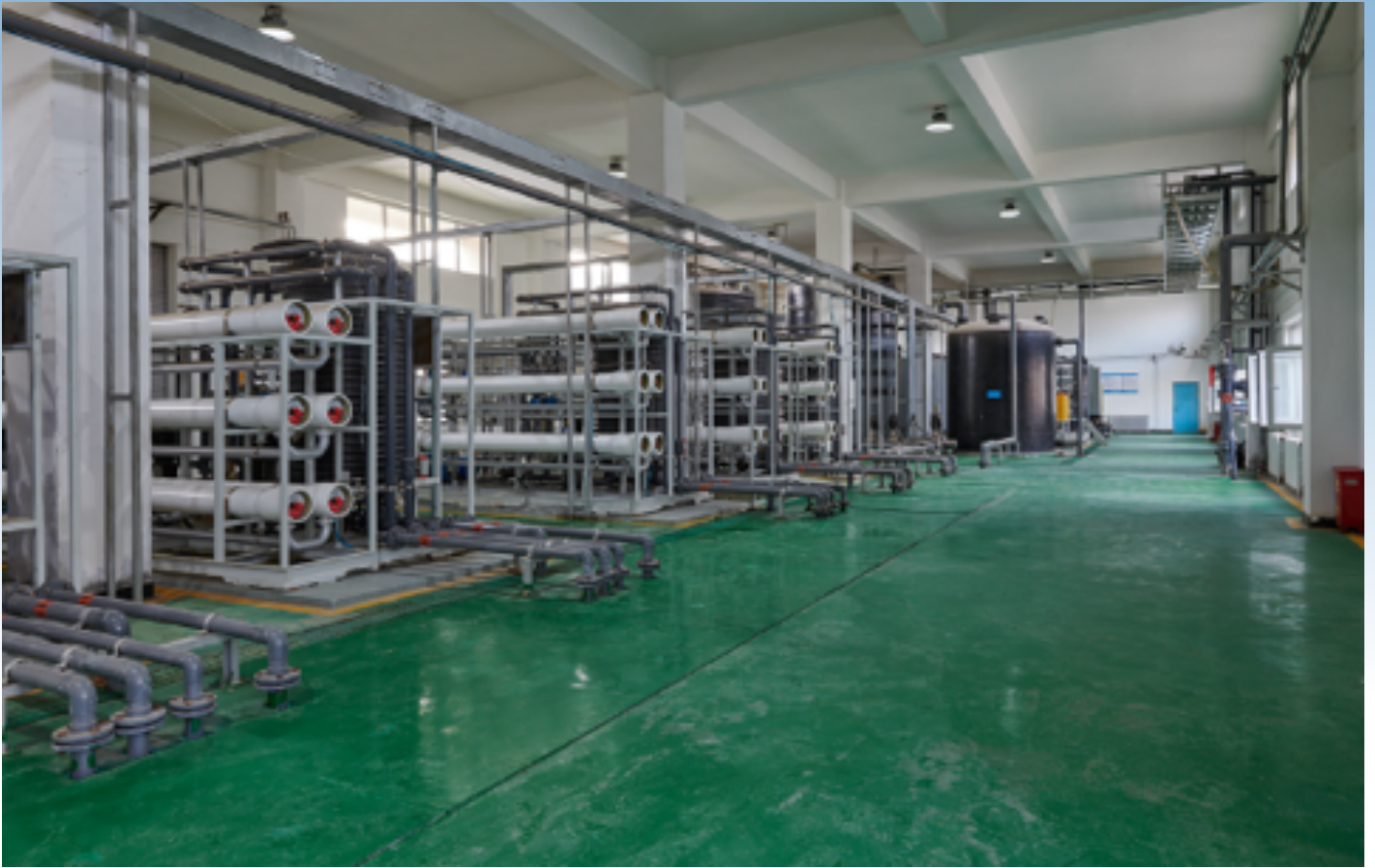
位于沈阳北部的渗滤液处理厂的维尔利公司膜处理设施。
