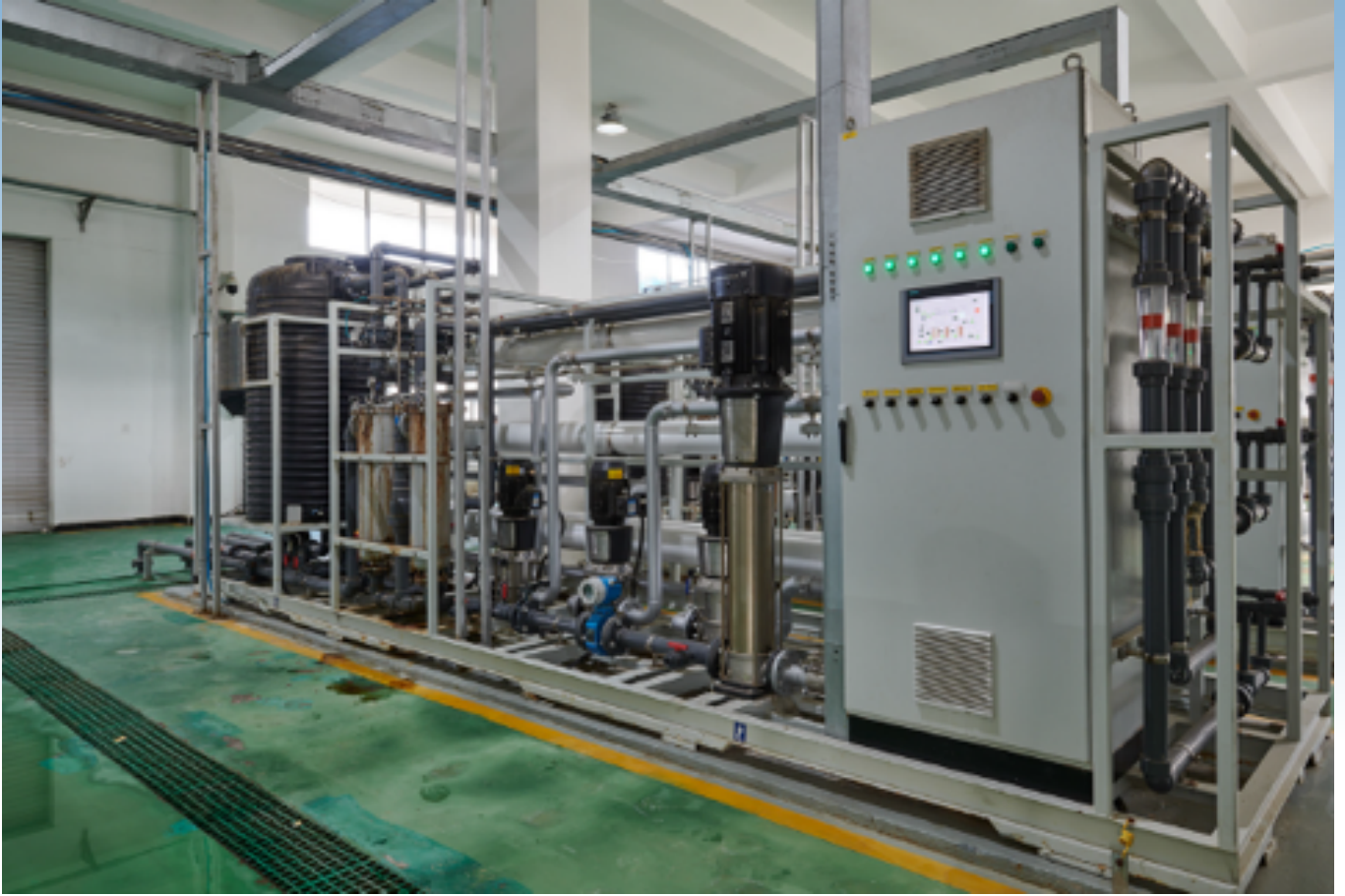
部分维尔利公司膜处理设施中的格兰富水泵 (CRN和CM水泵)。
